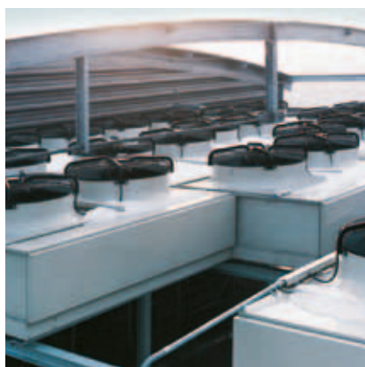
Охлаждение блоков вентиляторами
