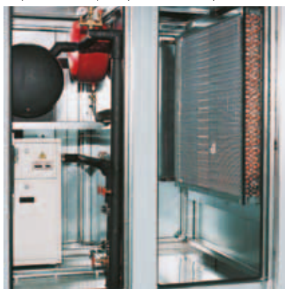
Охлаждение с модулем подготовки холодной воды
